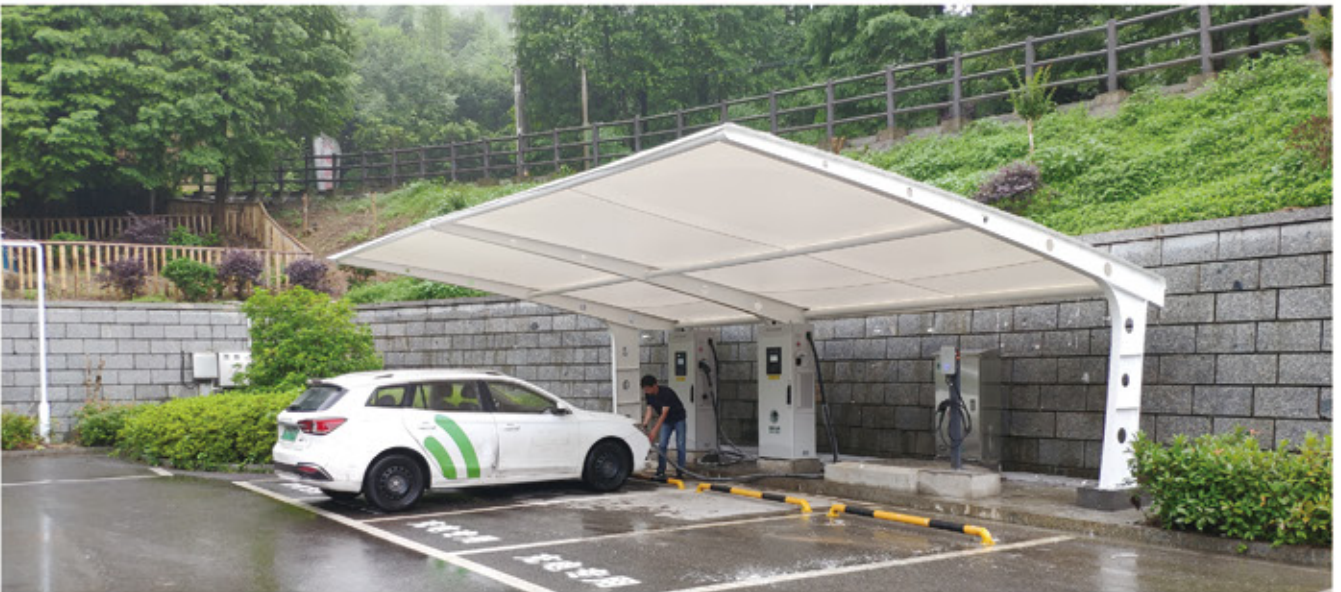
📍 安徽首个县域电动汽车充电设施乡镇全覆盖项目
