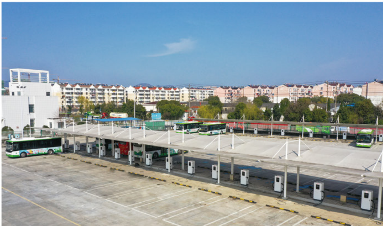
📍 巢湖公交停车场充电站项目
